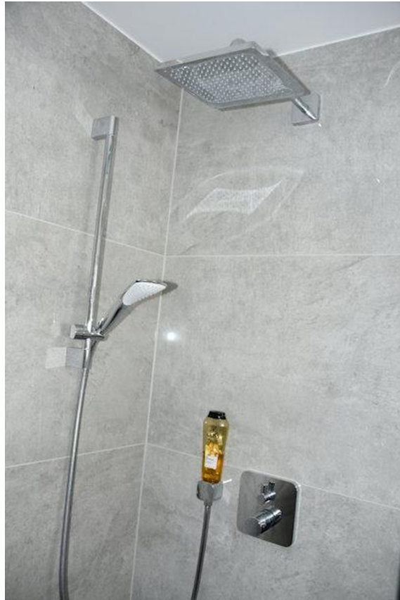
Dusche im Bad EG
