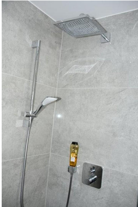
Dusche im Bad EG
