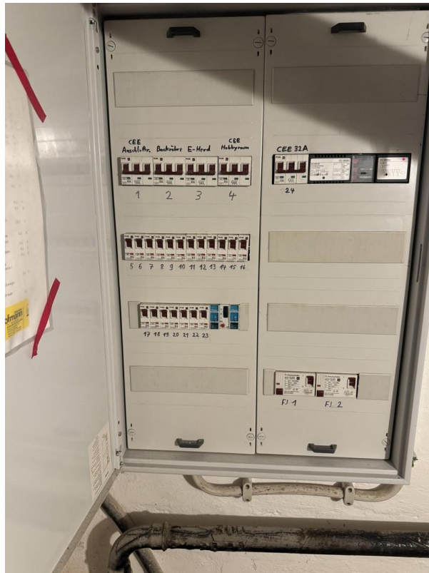
Schaltkasten mit 2 FI-Schalter
