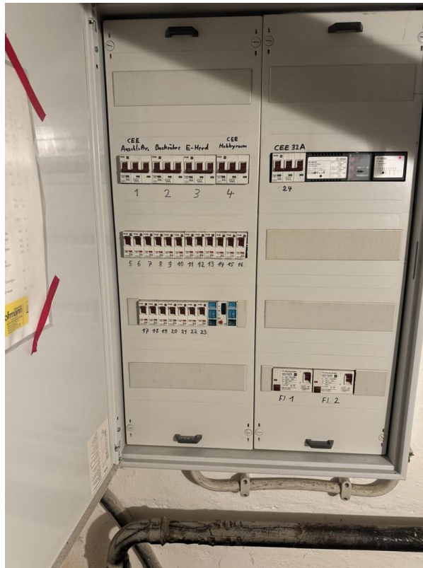
Schaltkasten mit 2 FI-Schalter
