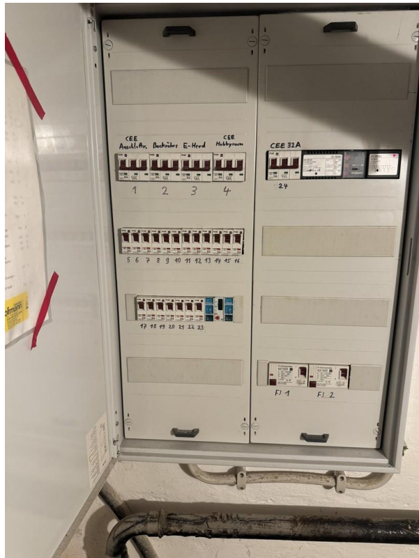
Schaltkasten mit 2 FI-Schalter
