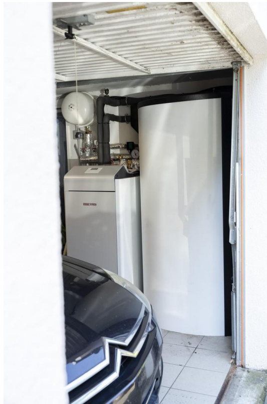
Erdwärmepumpe und Speicher
