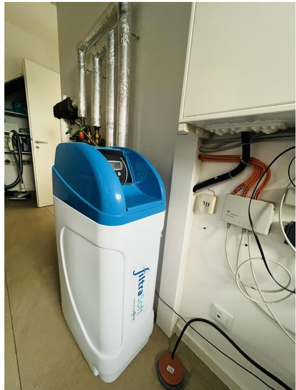
EG Technik Entkalkung
