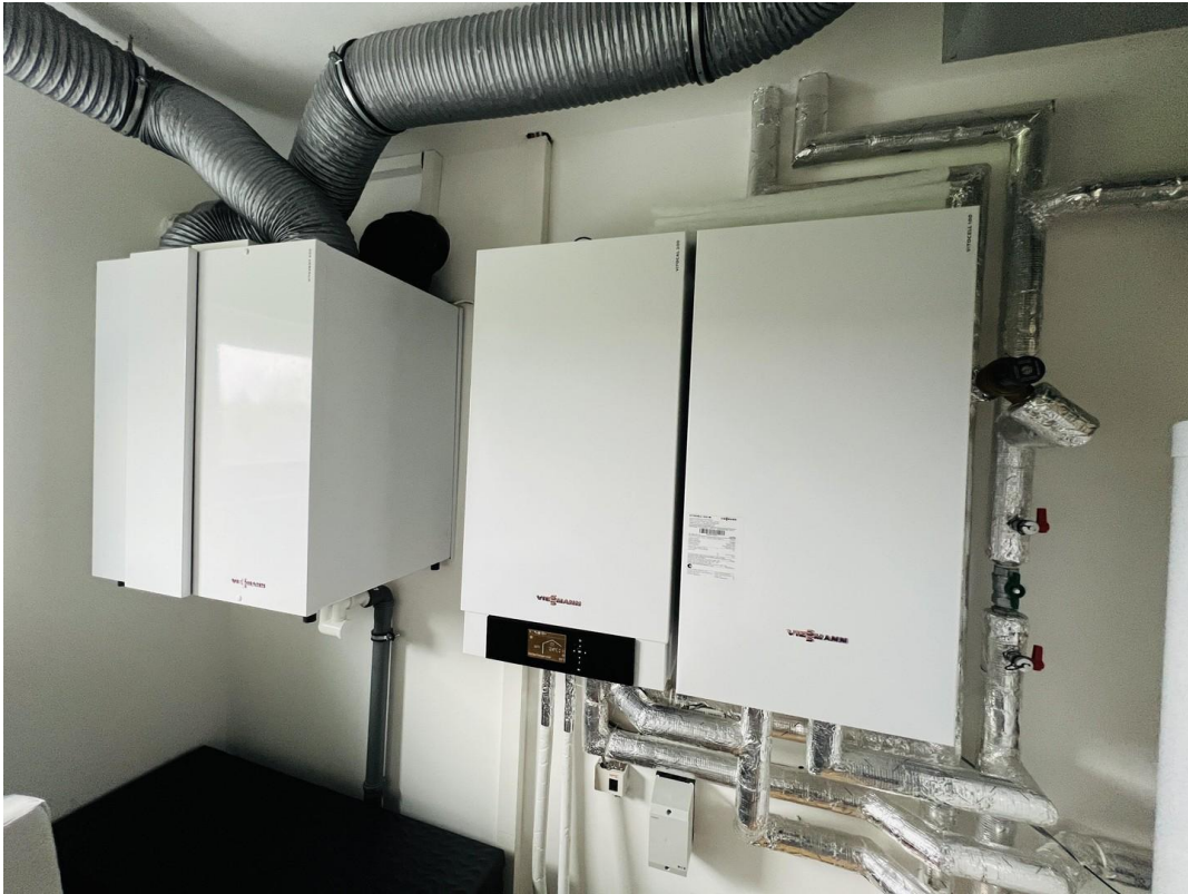
EG Technik Heizung
