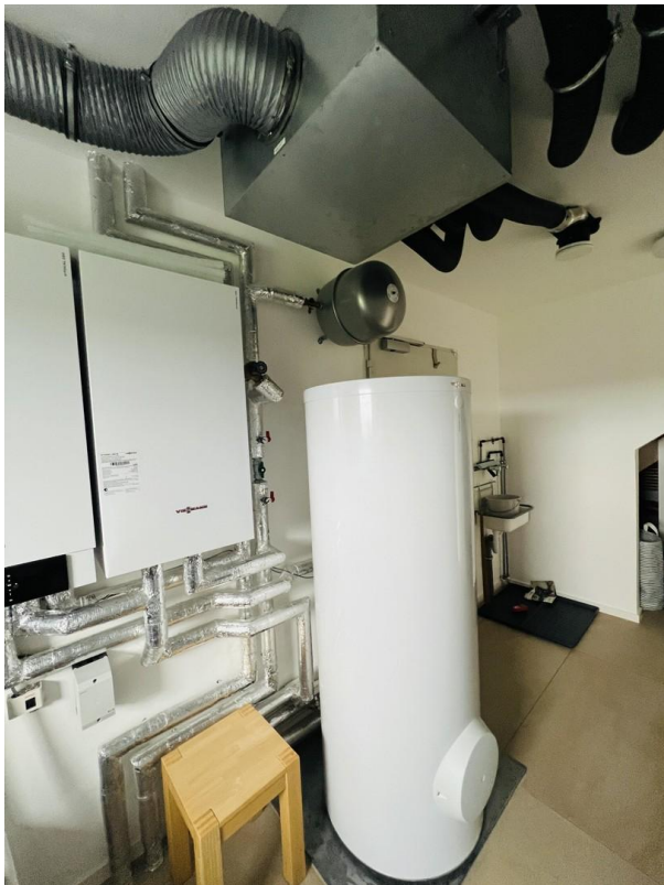
EG Technik Warmwasser
