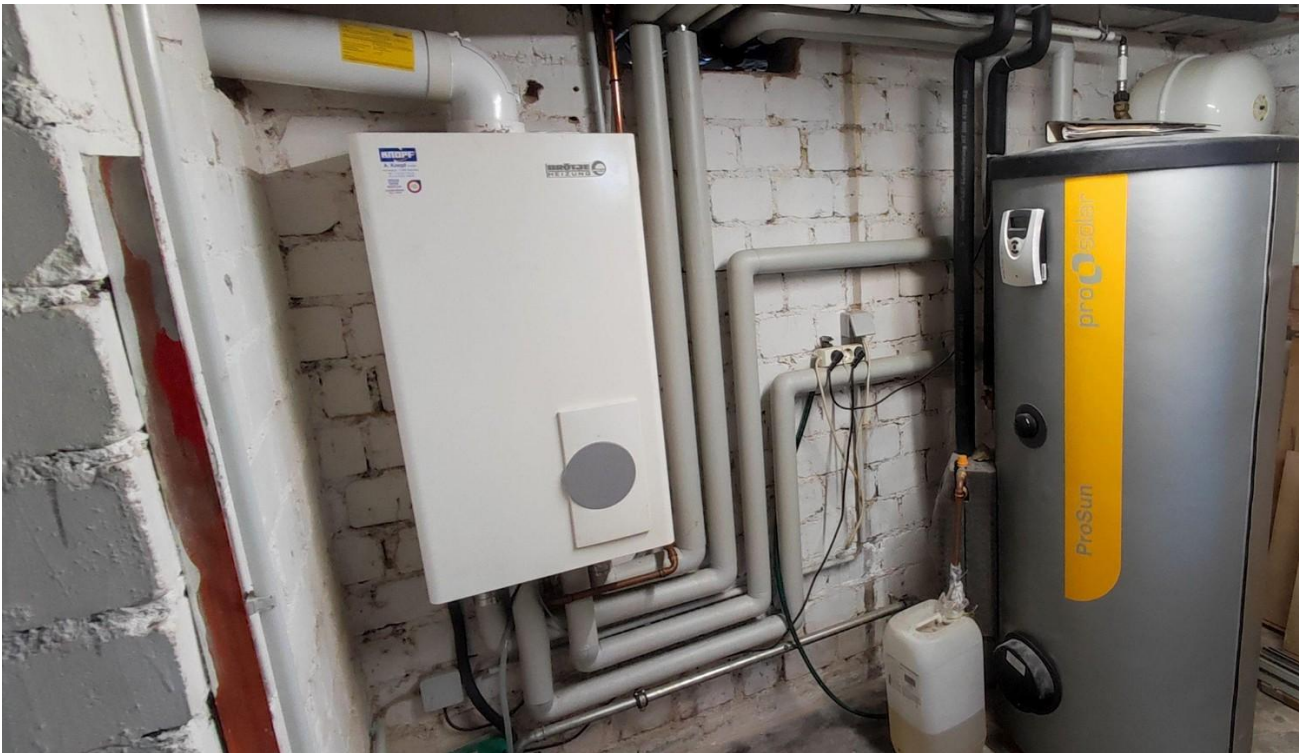
Heizung und Warmwasser
