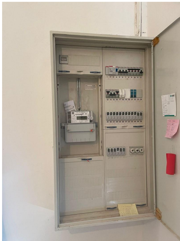
Sicherungskasten mit FI
