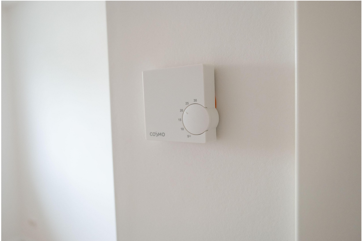
Fußbodenheizung (alle Räume)
