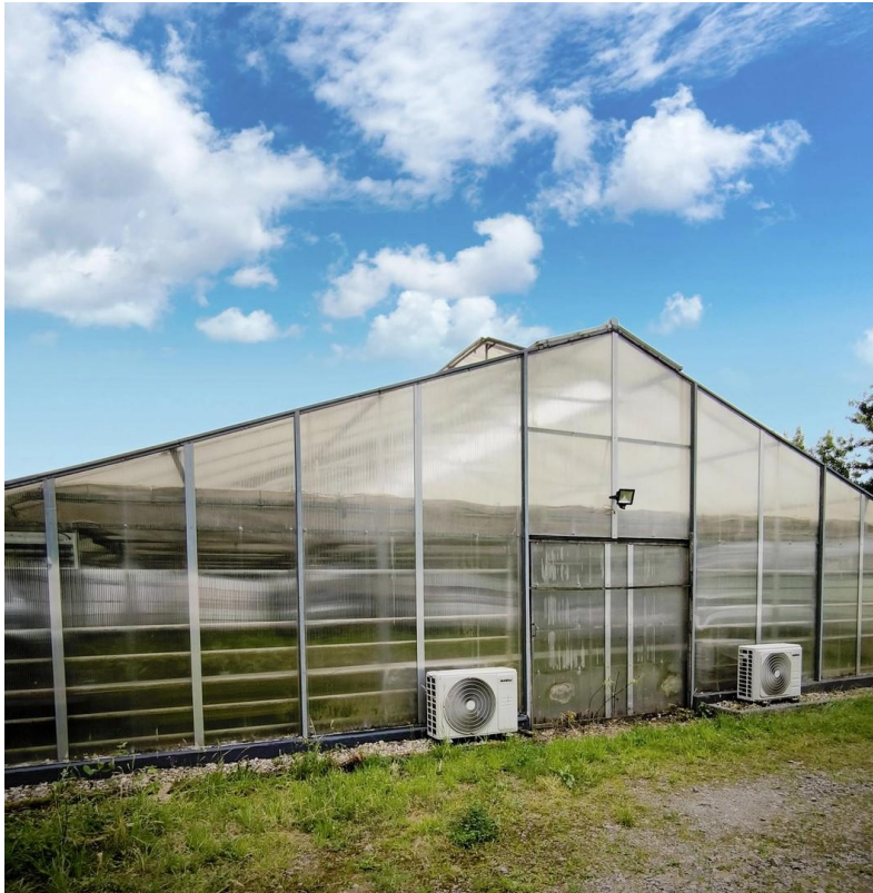
Rückseite mit Wärmepumpen
