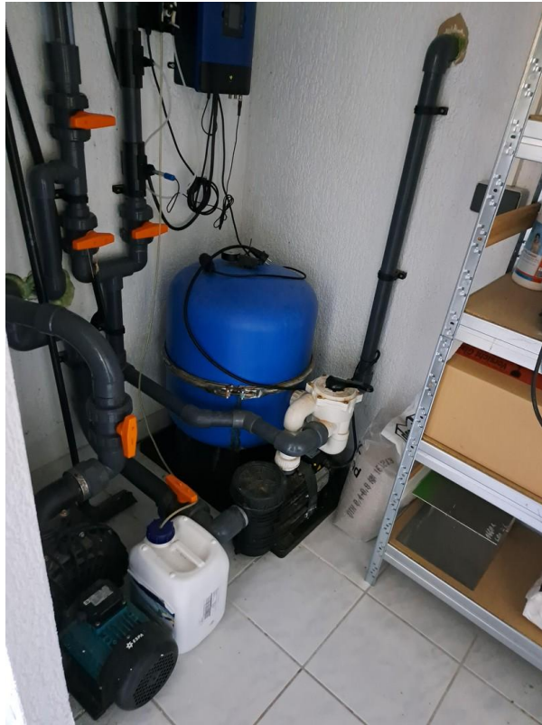
Pool-Technik im Keller
