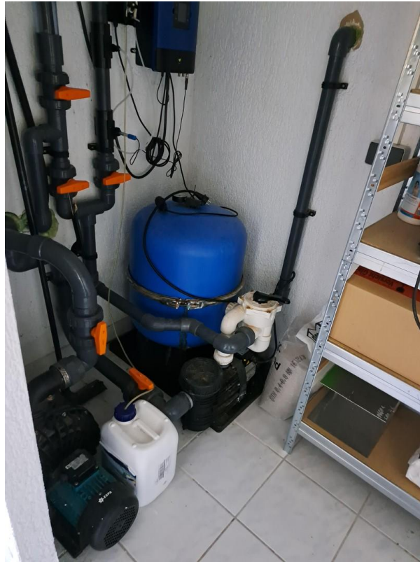
Pool-Technik im Keller
