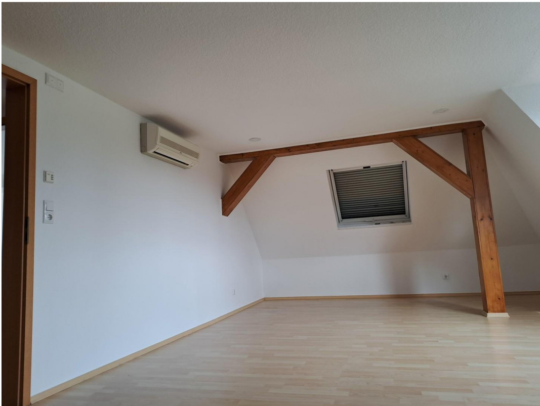
Klimaanlage im DG
