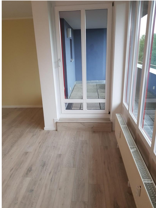
Terrassen-Tür im WZ
