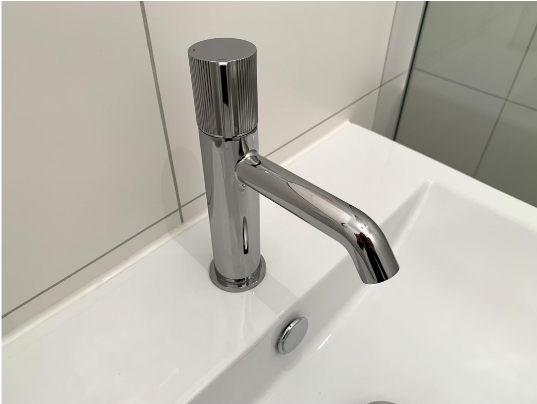
Armatur am Waschtisch Bad
