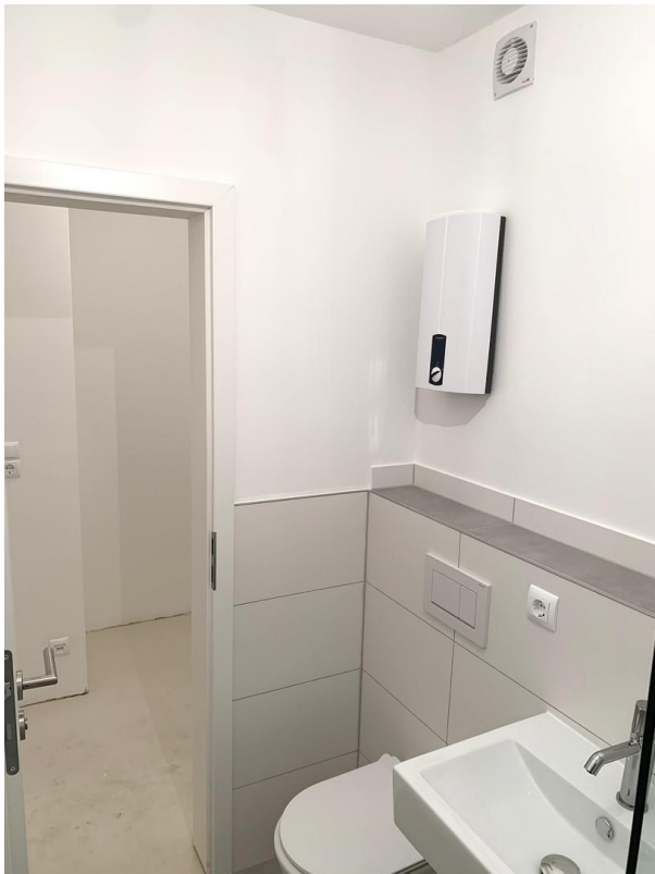
Bad mit Abluftabsaugung
