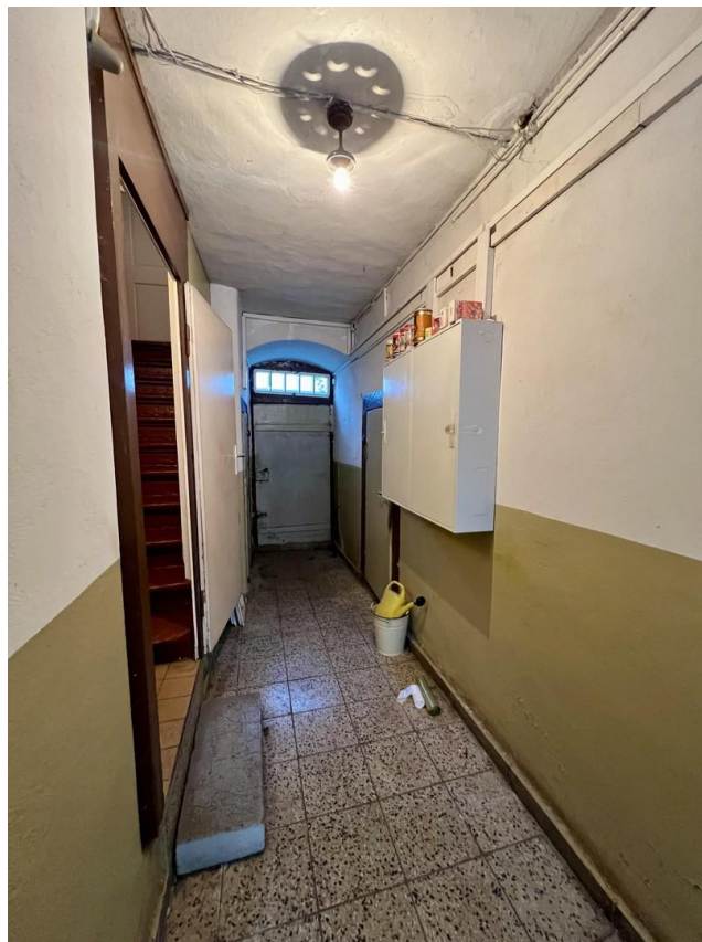
Hausflur mit Zählerschränken
