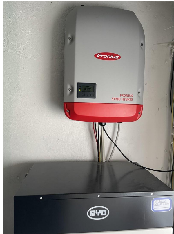
Wechselrichter mit Batterie
