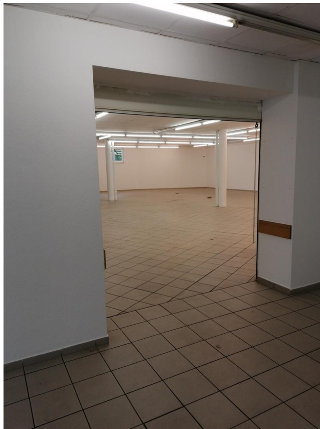
von Foyer Rolltür in gr. Laden
