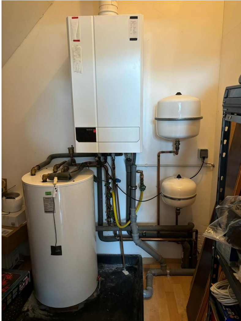
Abstellraum + Heizung 2.OG
