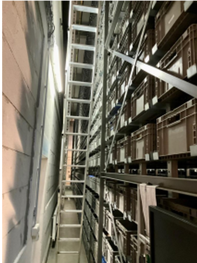
Kleinteilelager 7,77 m hoch
