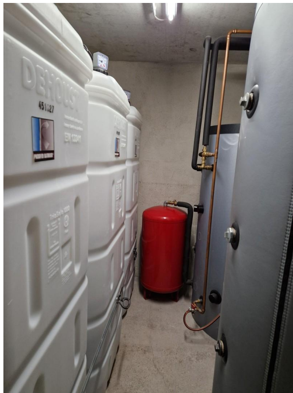
Öltankraum mit Wasserspeicher
