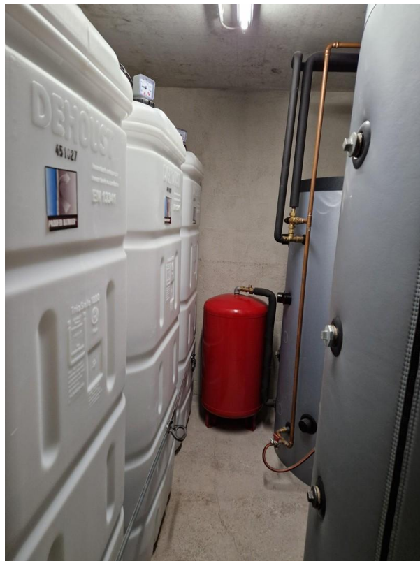
Öltankraum mit Wasserspeicher
