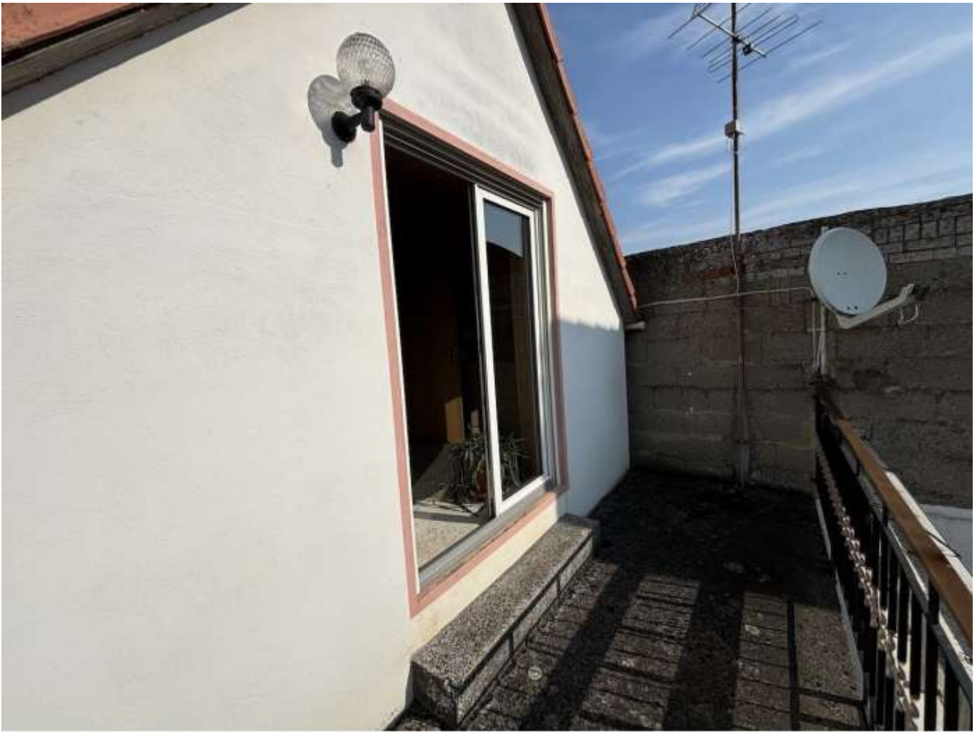
Übersichtsaufnahme der Terrasse im DG (Raum 3.03). Im Bildmittelgrund ist die zweiflügelige Zugangstür zum Flur im DG (Raum 3.01) erkennbar.
