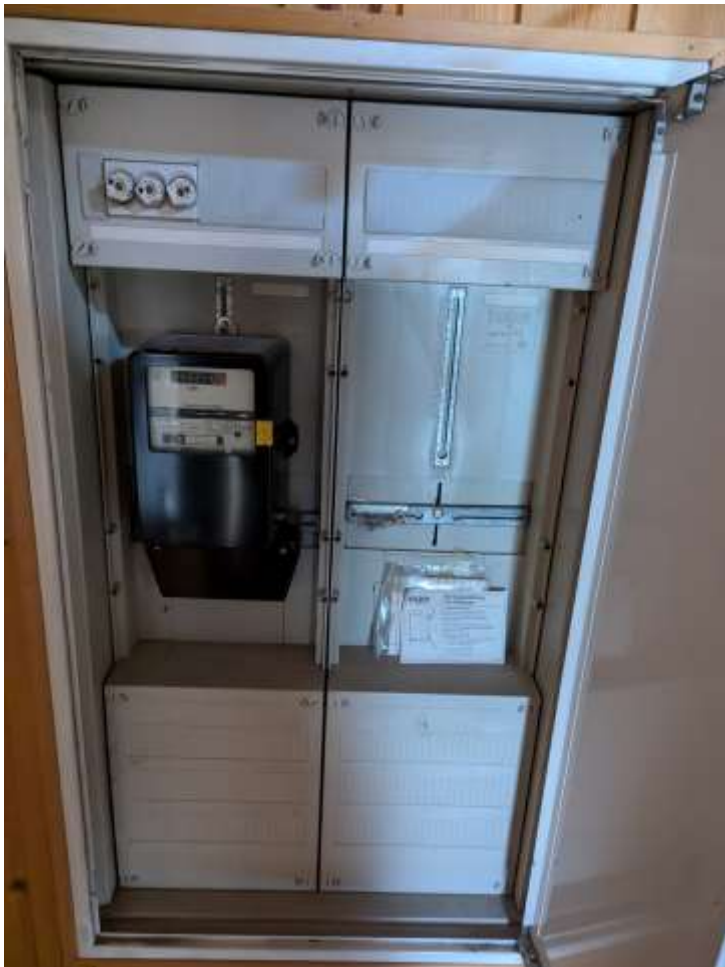
Detailaufnahme ELT (Zähler und Sicherungskasten) im Flur OG (Raum 2.03)
