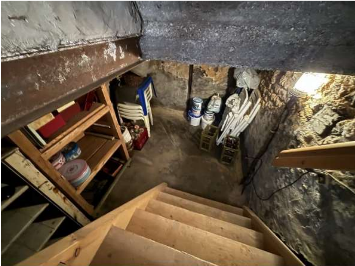
Zugang zum Gewölbekeller unter der Küche (1.01), Hervorragend für Wein und andere Lebensmittel, die natürlich gekühlt werden sollten.
