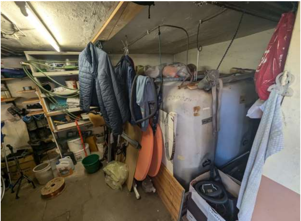
Detailaufnahme / Innenansicht Werkstatt bzw. Heizraum (Raum 1.07), Blick nach rechts mit den 2x2000l Öltanks
