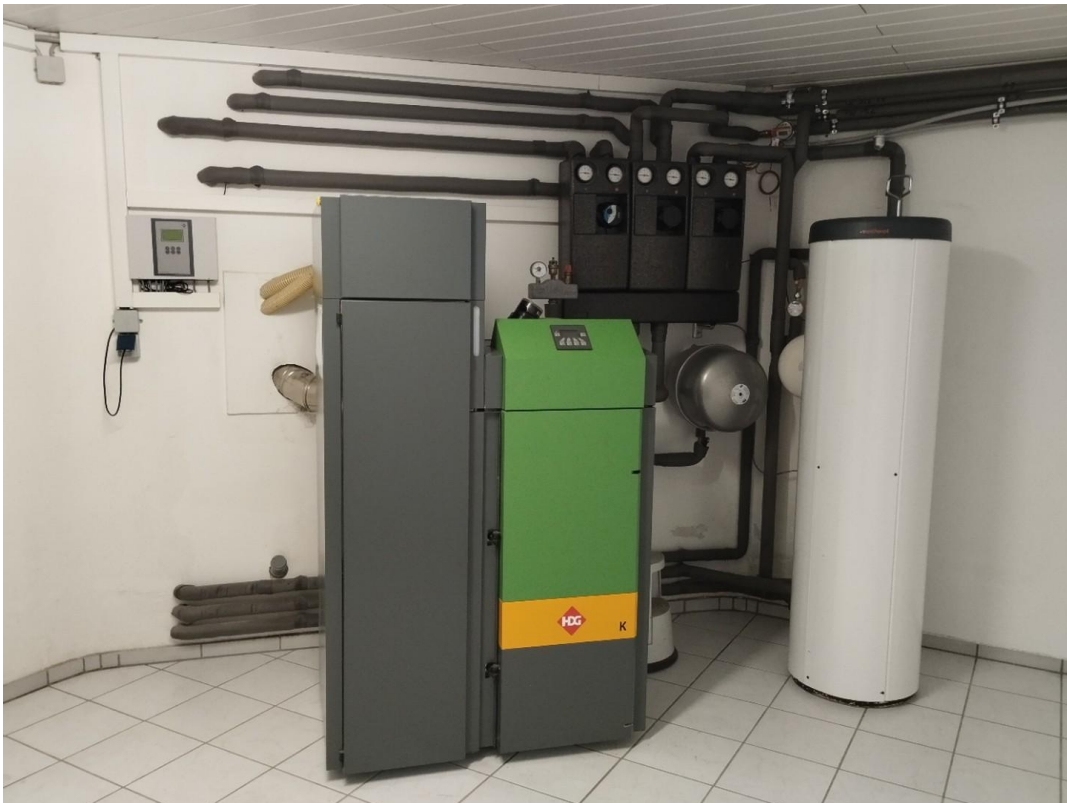
Pelletheizung Fabrikat HDG
