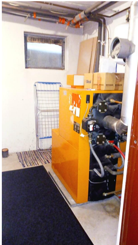
Keller-Heizungsraum mit 2 Ölta
