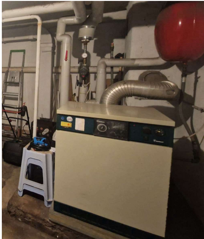
Heizungsanlage im Keller
