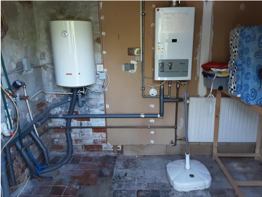
Anbau Heizung Wirtschaftsraum
