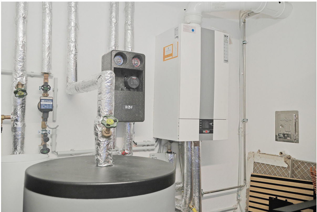
Heizung und Speicher
