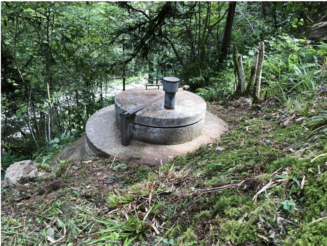
Brunnen für Wasserverorgung
