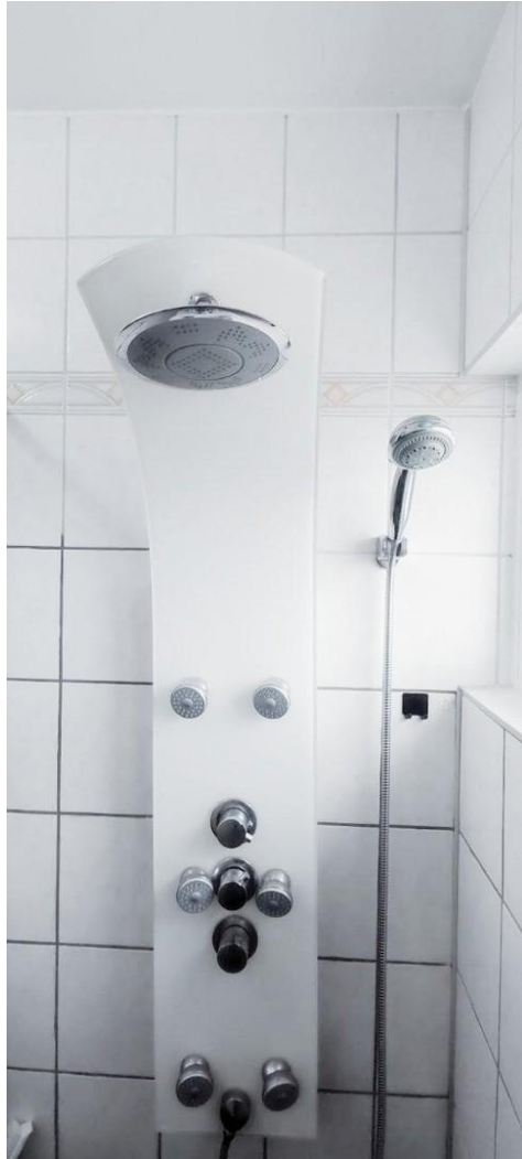
Duschpaneel in Badezimmer
