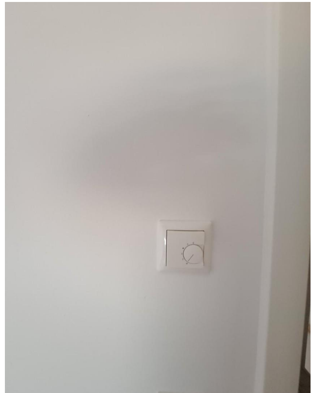
Regelung für die Heizung
