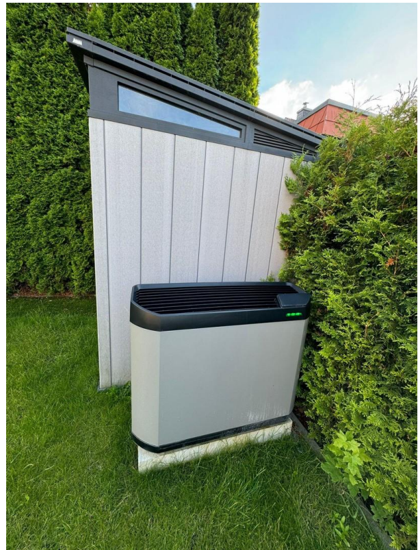
Technik Pool + Wärmepumpe
