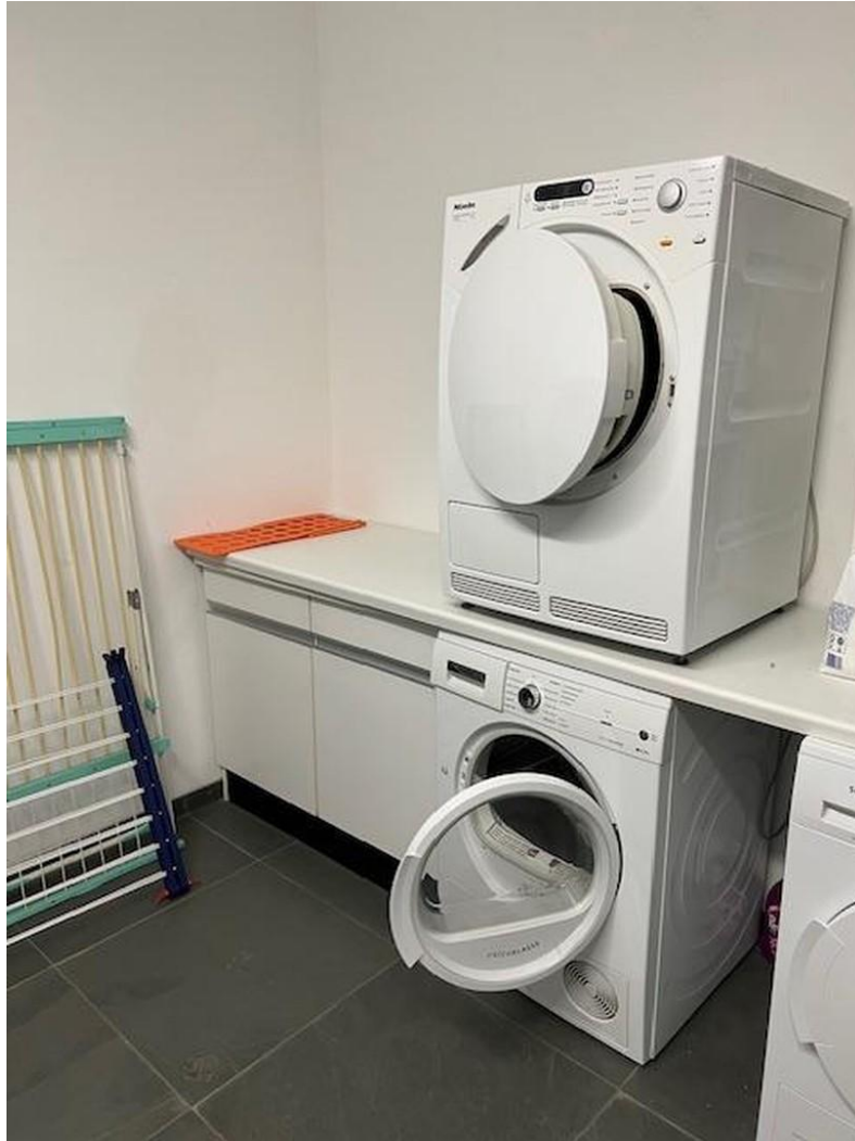
Waschraum (im Keller)
