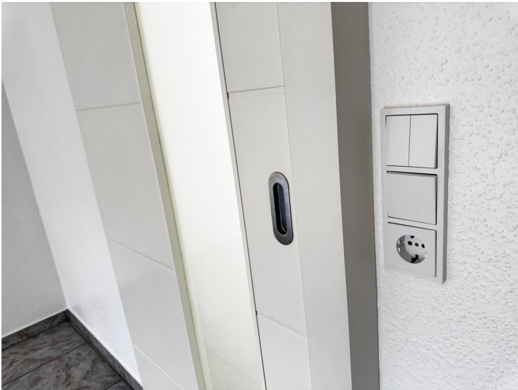
Schiebetür - Neue Schalter
