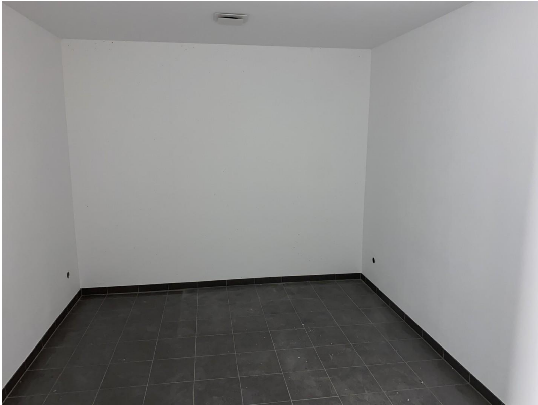
Kellerraum, beheizt, belüftet
