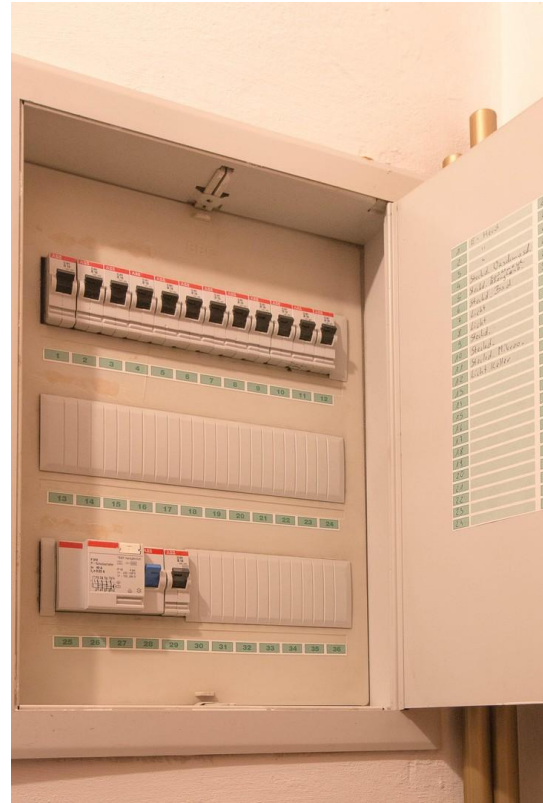
Sicherungskasten mit FI
