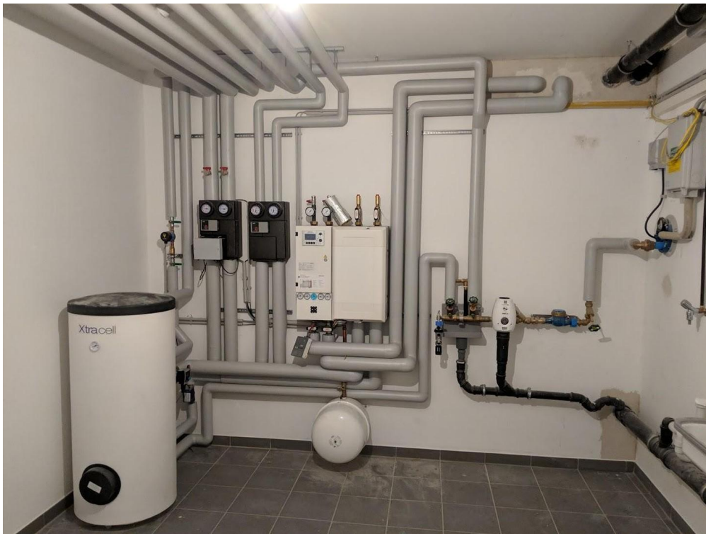
Technikraum und Waschküche - U
