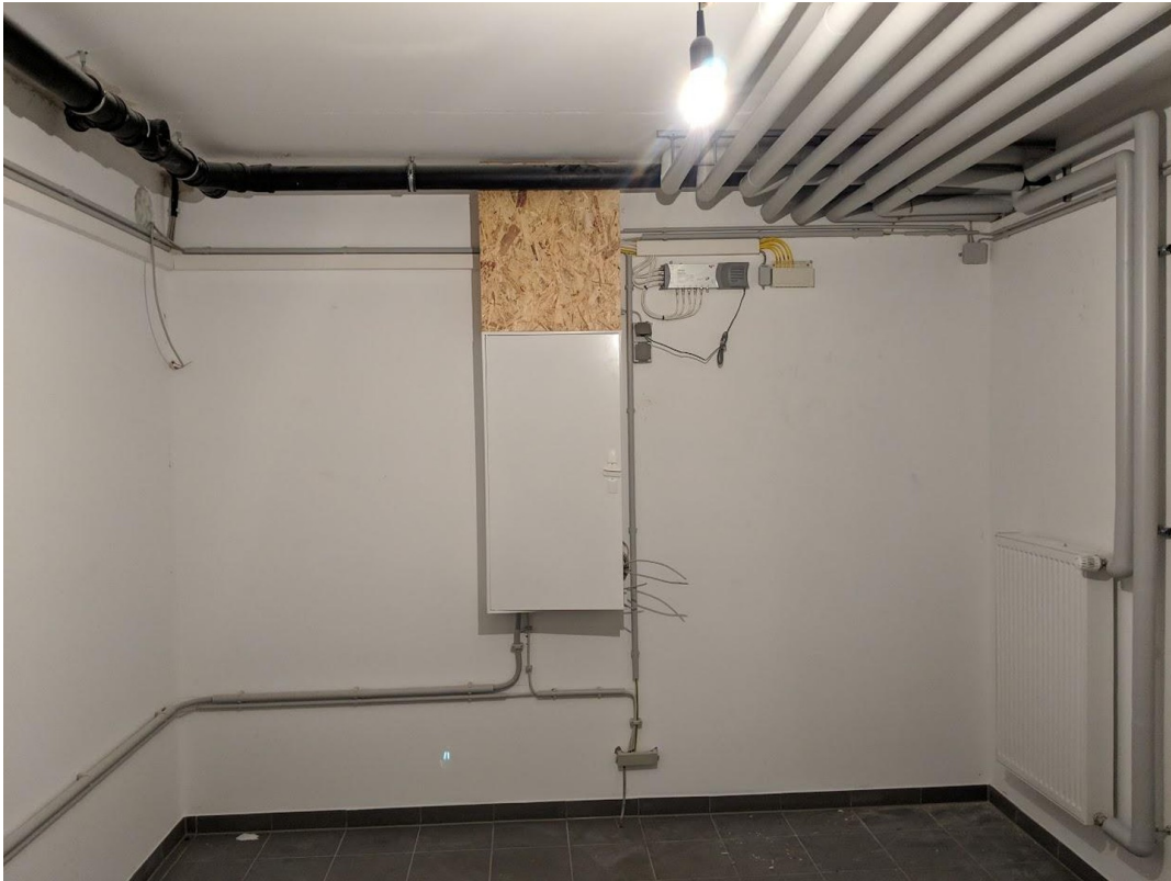
Technikraum und Wäsche - UG
