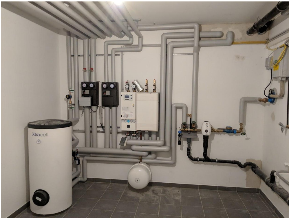
Technikraum und Waschküche - U
