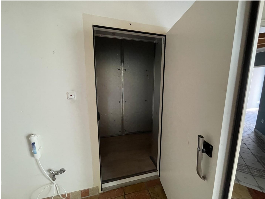
Haus Küche Kühlzelle
