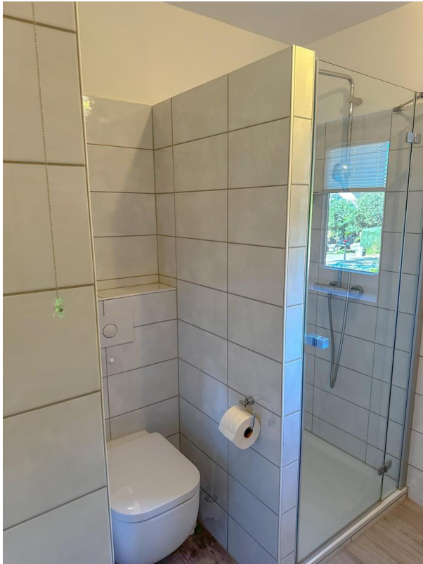
Duschbad mit WC
