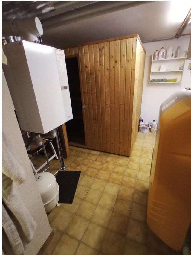
KG Heizung mit Sauna
