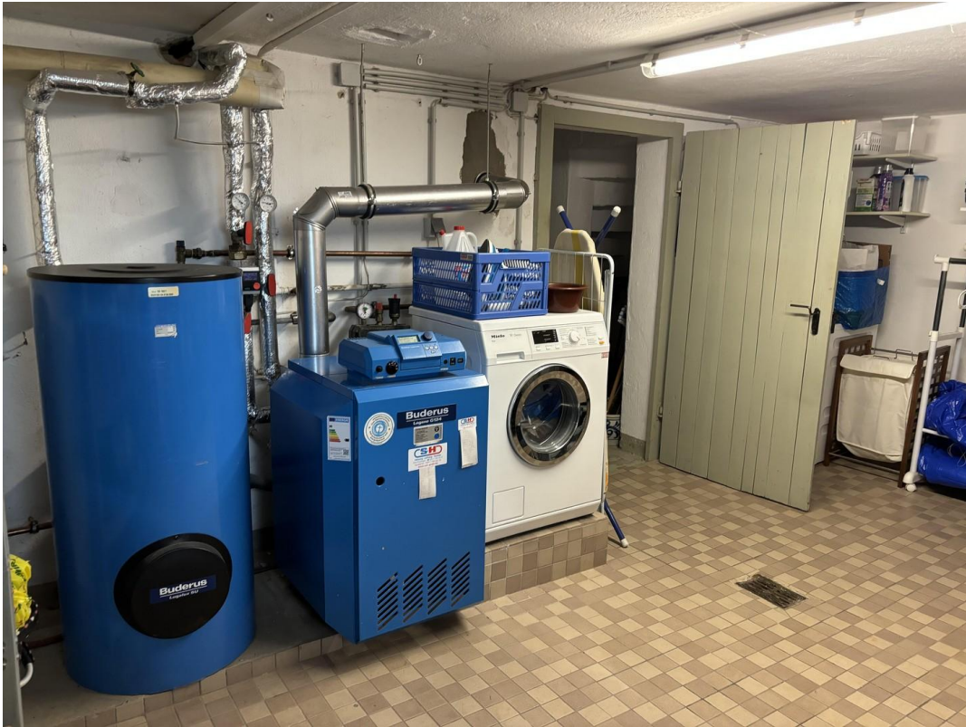
Keller mit Gasheizung
