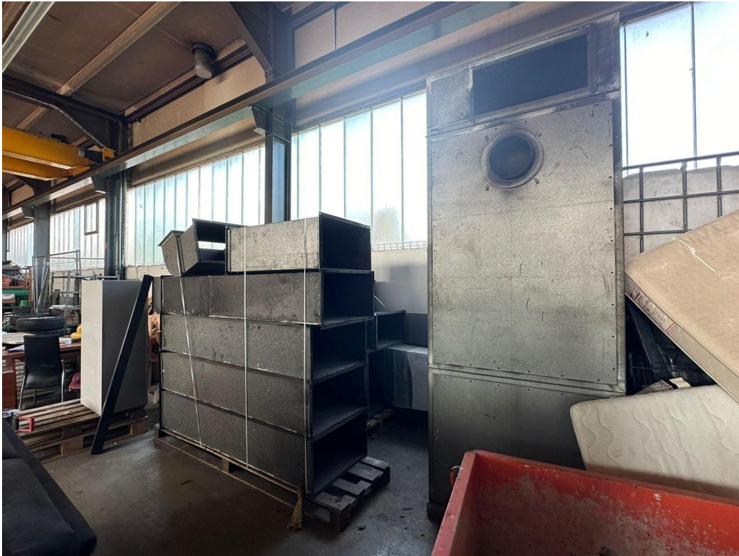
Öl Heizung inkl. Lüftung
