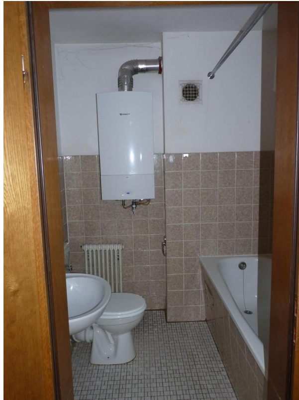
Whg.4 Therme gerade erneuert
