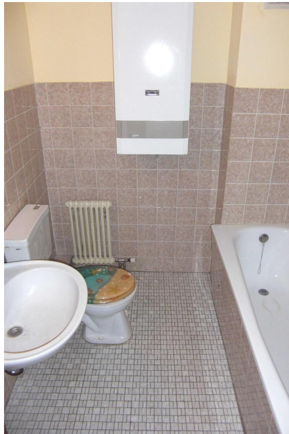
Whg. 2 Therme gerade erneuert
