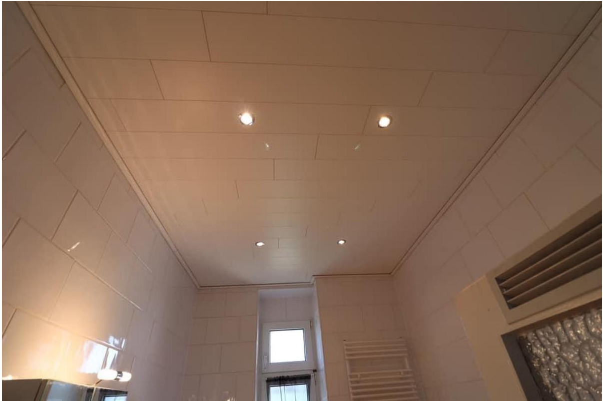
Decke mit LED Spots 6ZKB
