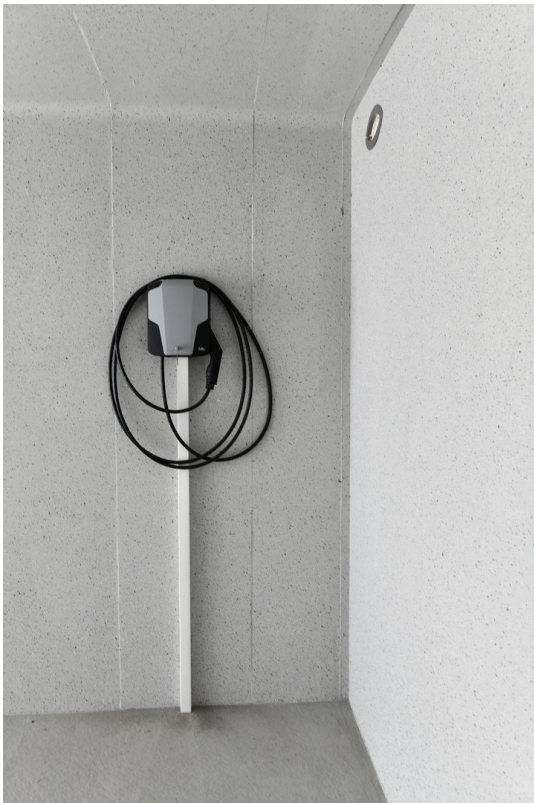
Wallbox installiert m. Zähler
