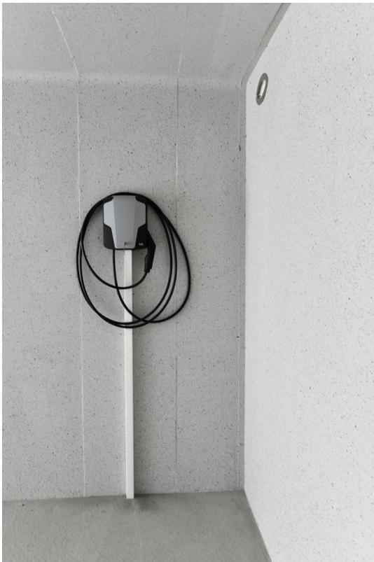
Wallbox installiert m. Zähler
