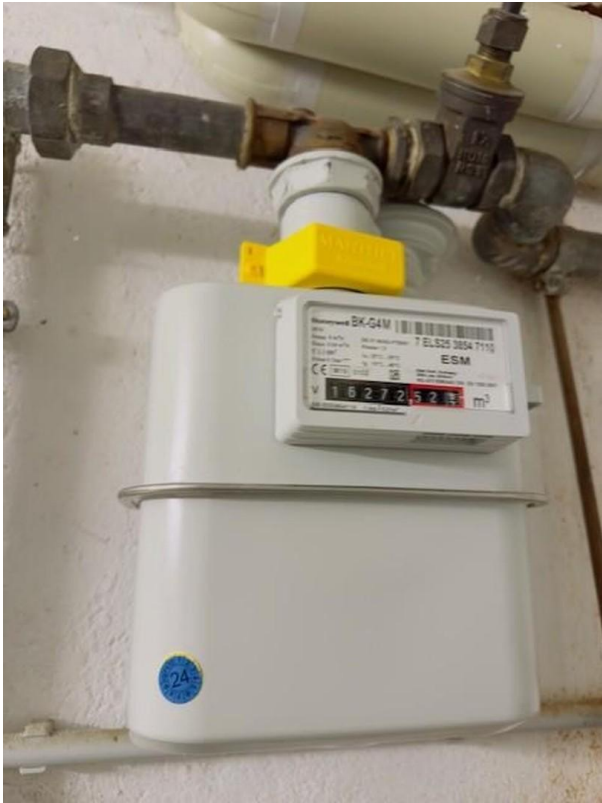
Gasheizug EG und 1.OG
