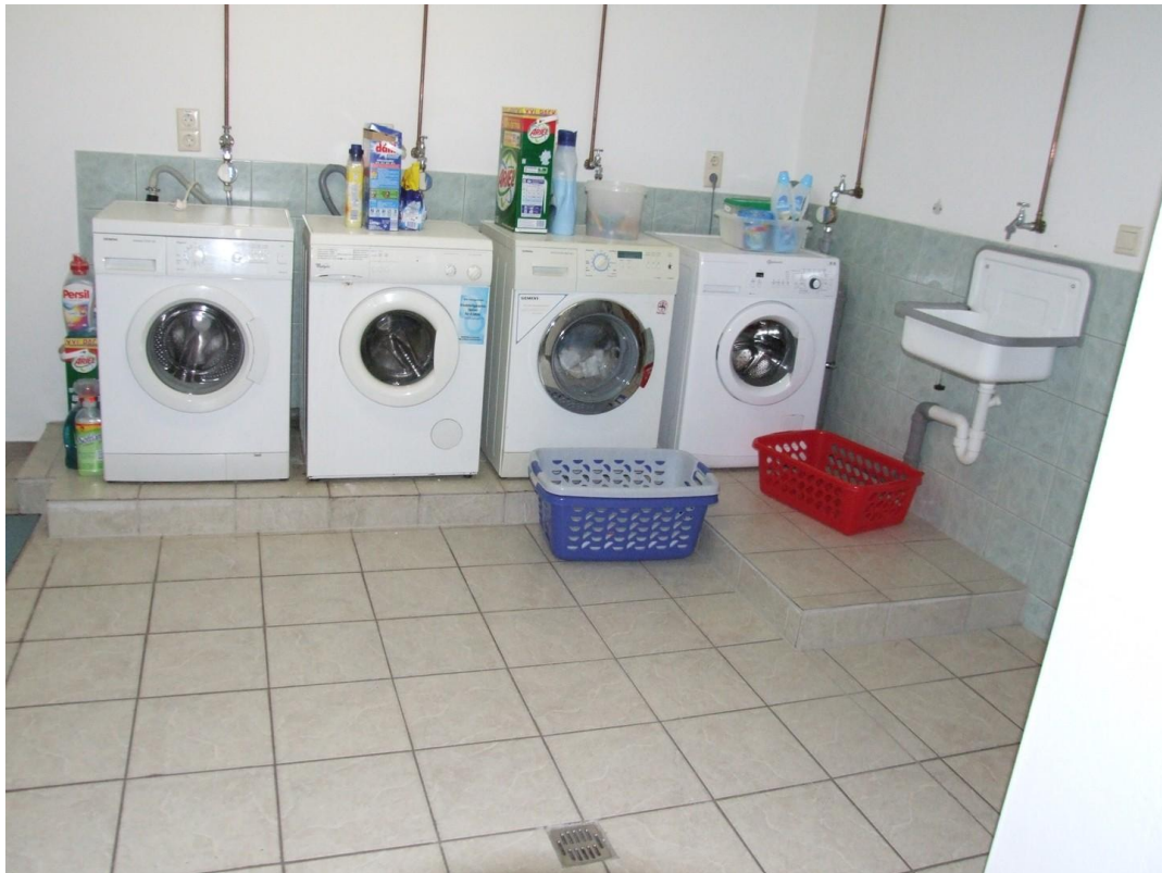
Wasch und Trockenraum
