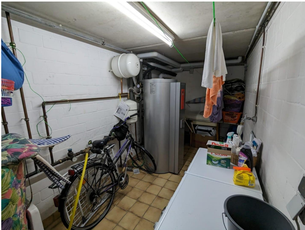
Heizung, Wasch-u. Trockenraum
