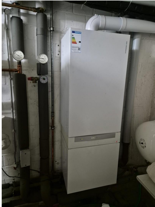
Neue Heizung KG
