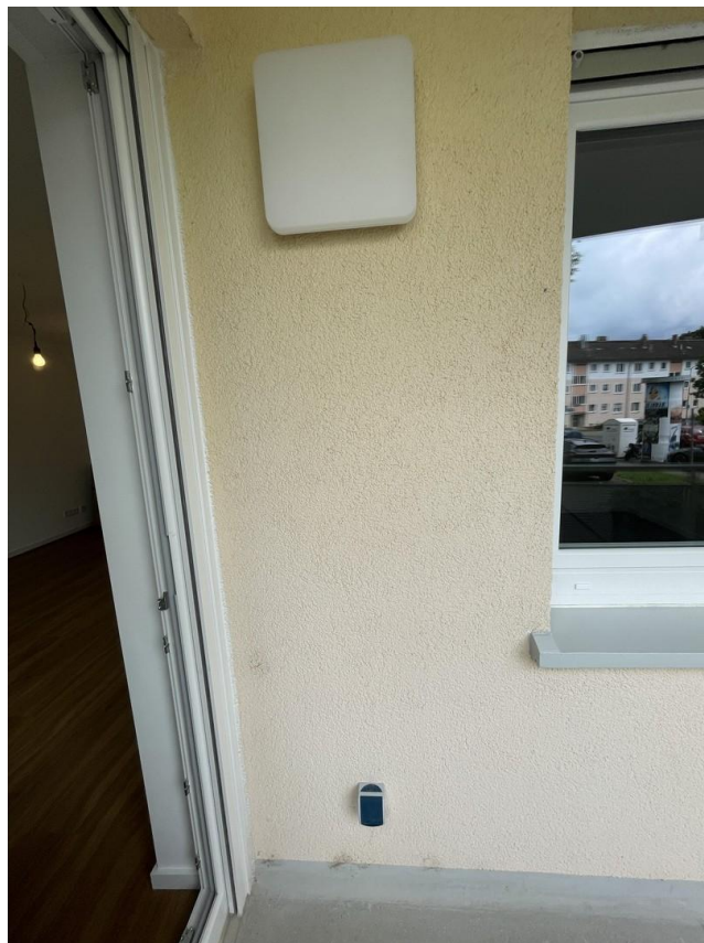
Balkon - Strom und Licht
