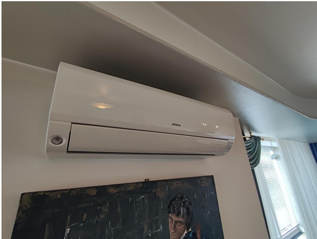
Klimaanlage EG WoZi
