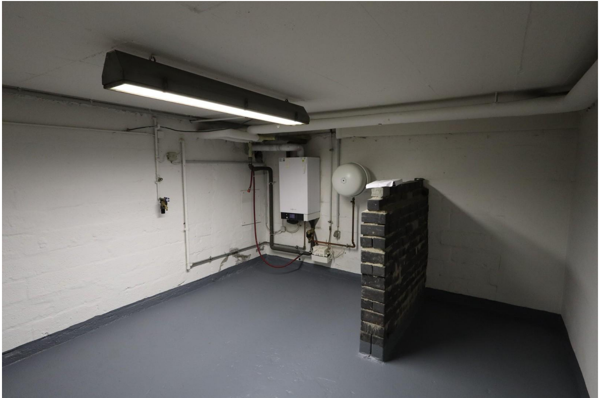
Heizungskeller mit Gastherme
