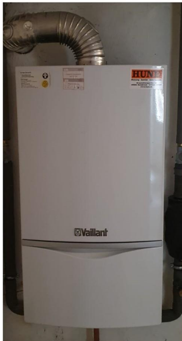
Gaswandheizgerät 2018 neu installiert
