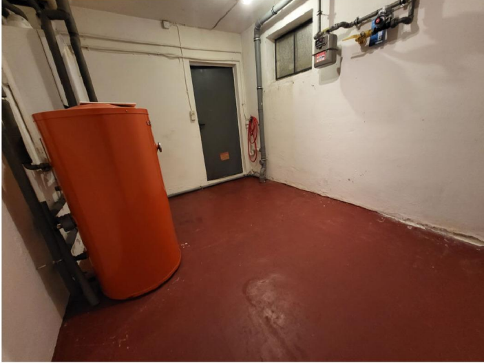
Heizungskeller UG (Gas-Zentralheizung BJ 2006)
