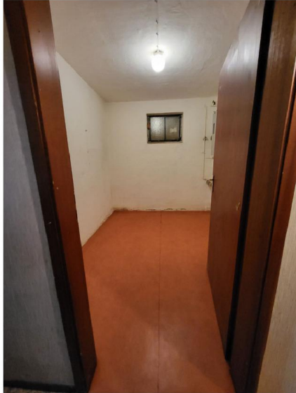
Kellerraum (Hausanschlüsse Strom, Wasser) UG
