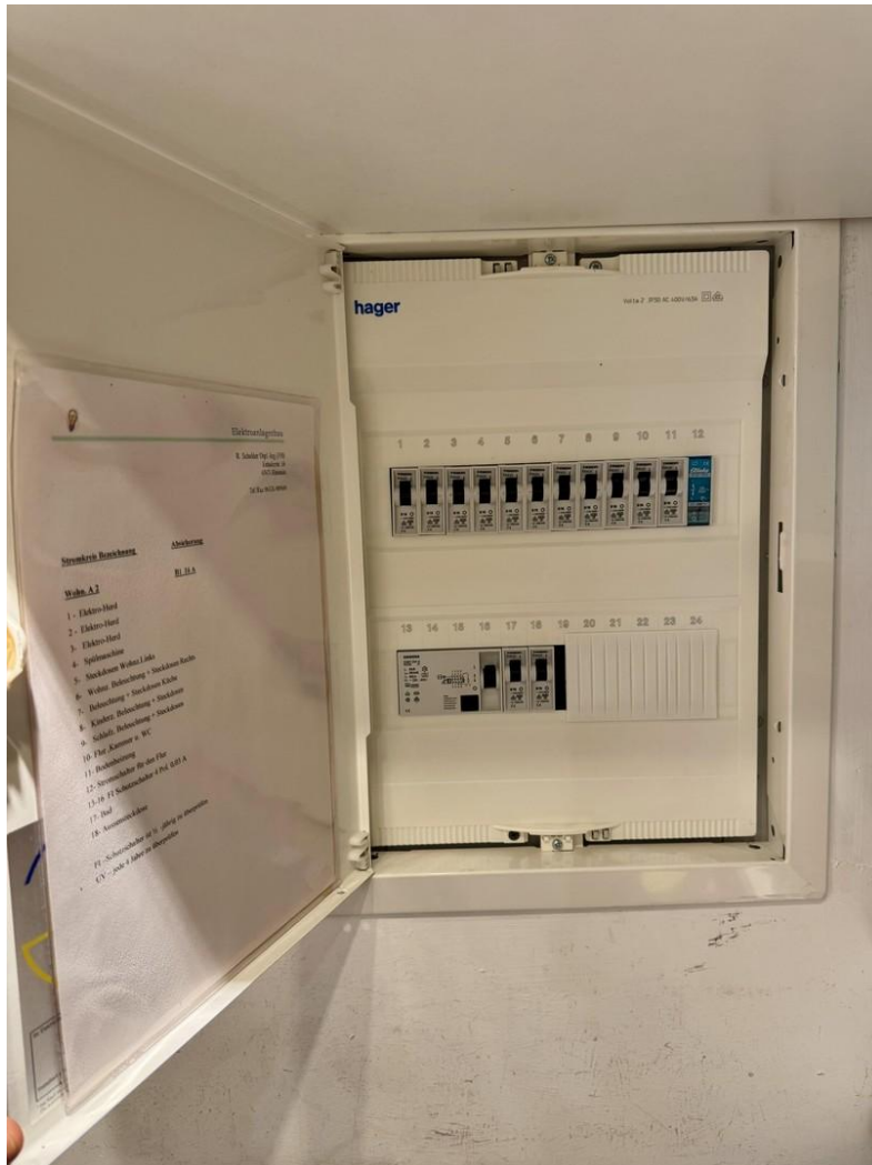
Sicherungskasten mit RCD
