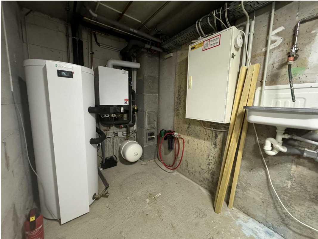
Haustechnik und Lager (Keller)
