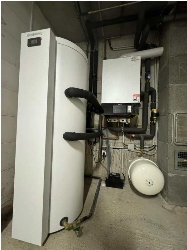
Heizung mit WWWP (Keller 2023)
