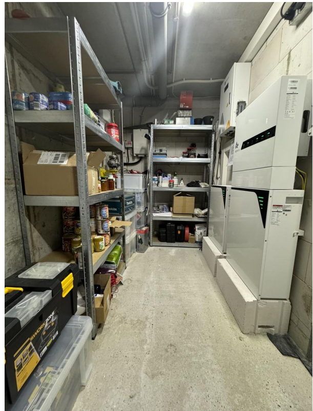
Haustechnik und Lager (Keller)
