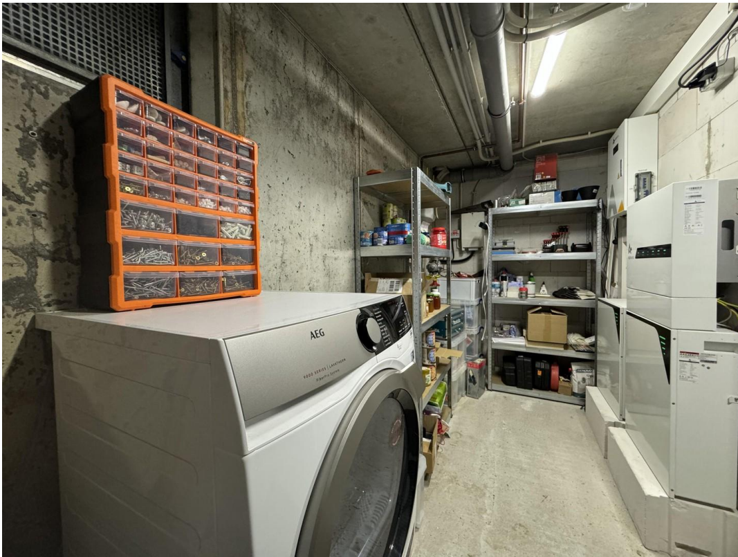
Haustechnik und Lager (Keller)
