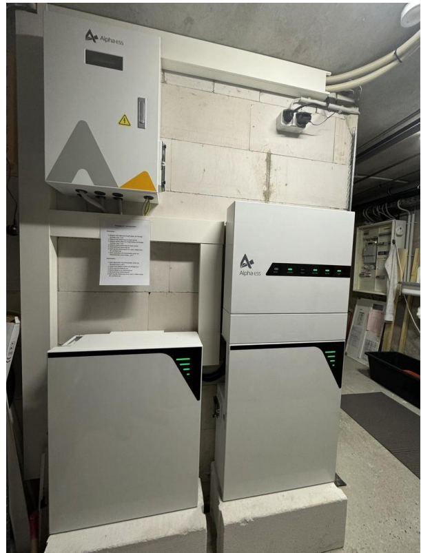
PV-Anlage mit Notstrom (2023)
